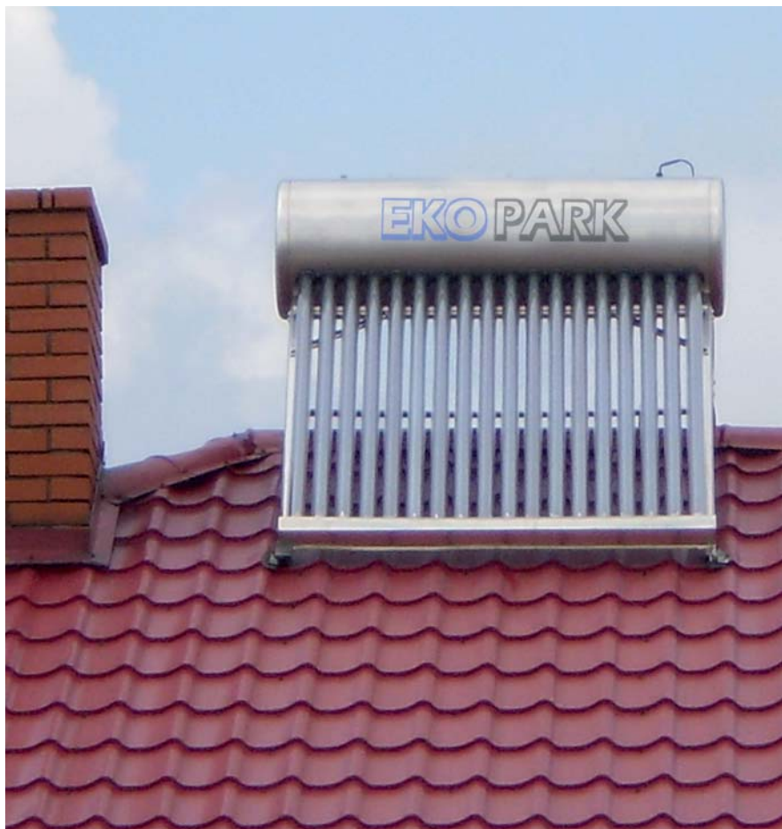
Rys. 5. Zainstalowany wodny kolektor słoneczny EkoPark
